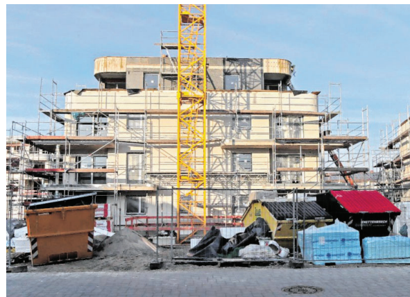
Bestes Praxisbeispiel: Das Antoniusquartier in Plankstadt umfasst 58 Wohneinheiten pro Hektar. Das Foto vom Westende stammt vom Januar 2022. ARCHIVBILD: LENHARDT
