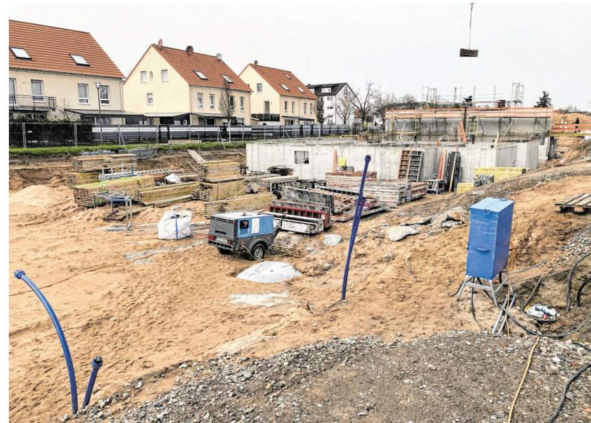
Sie sind die vorerst letzten großen Bauprojekte im Neubaugebiet Bäumelweg-Nord. Vier Mehrfamilienhäuser in Holzbauweise entstehen dort, Bauherr ist die Stiftung Schönau. Diese Mischung aus Ein- und Mehrfamilienhäusern liegt im Trend. BILD: STRAUCH
